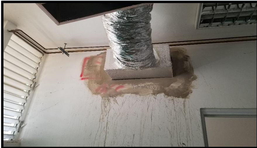
DUCTERIAS A/A. NO CUMPLE NORMA
