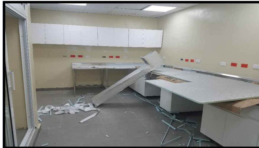
LABORATORIO INSTALACION DE CLIMATIZACION
