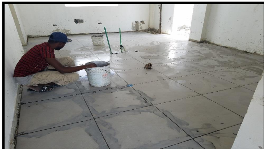
MORGUE COLOCACION DERRETIDO EN LOSETAS
