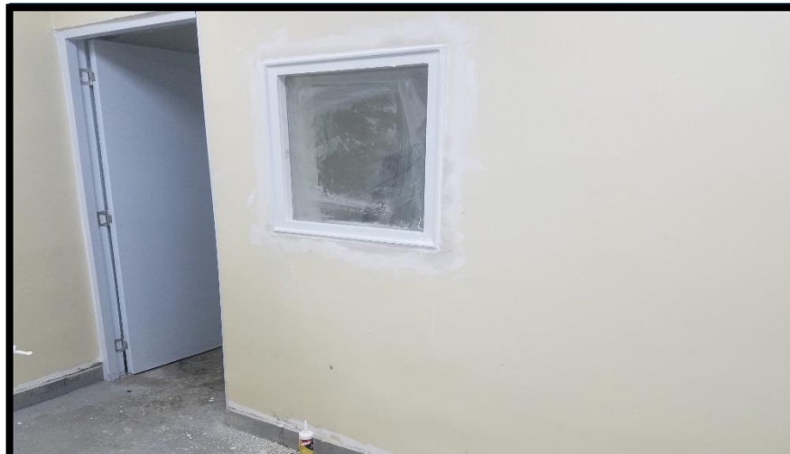
RAYOS X INSTALACION DE CRISTAL PLOMADO
