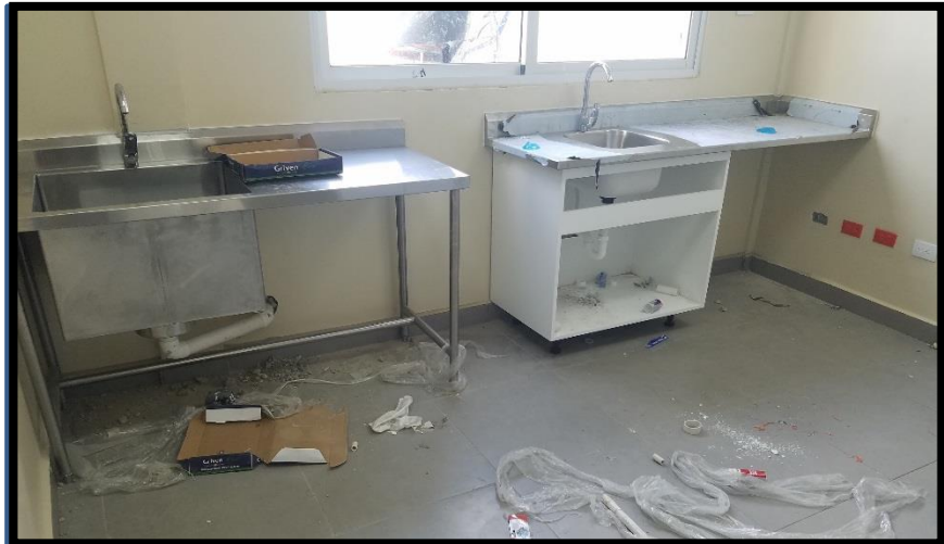
SALA DE YESO INSTALACIONES SANITARIAS
