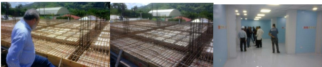
Supervisión construcción del Hospital de Hondo Valle, de la provincia Elías Piña.
