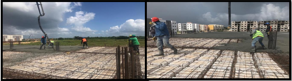
Supervisión de la ejecución de trabajos en Centro de Diagnóstico y Atención Primaria Ciudad Juan Bosch
