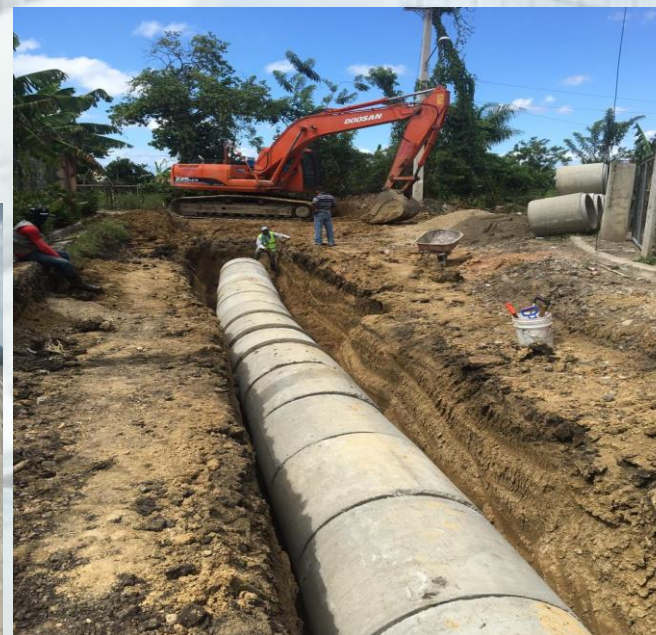
RECONSTRUCCIÓN CALLES BARRIOS KALAC II, BARRIO LAS FLORES Y CALLEJÓN DE TERO, PROV. ESPAILLAT
